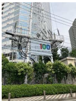
送電鉄塔設置したサイネージ で100周年PR動画を配信 (東京電力パワーグリッド株式会社川崎支社)
